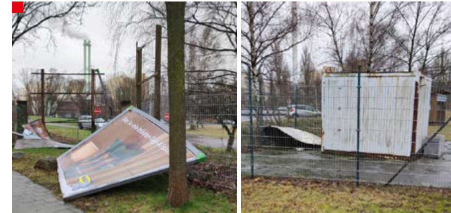
Der Orkan Zeynep richtete zahlreichen Schäden auf dem Verkehrsübungsplatz an.
