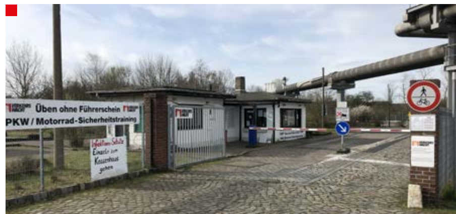
Stetiger Regen führte zu einem Wassereinbruch im Dachbereich des Einlassgebäudes.
